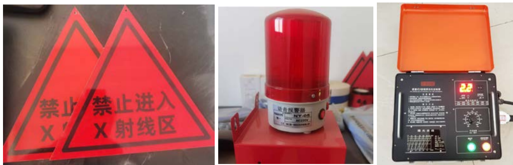
图 22 安全警示标志、警示系统照片
