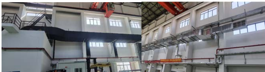
图 23 现场排风系统照片
