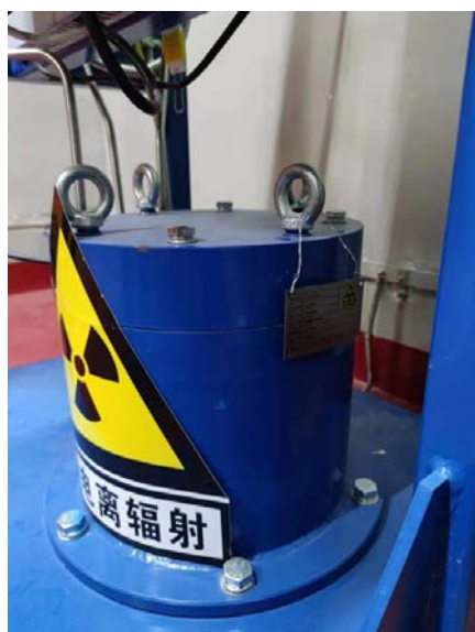
b) LF1110 尾气处理系统出口惰性气体监测仪
